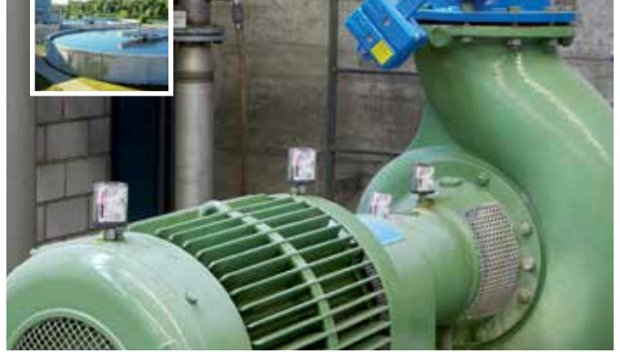
Nhà máy xử lý nước thải
